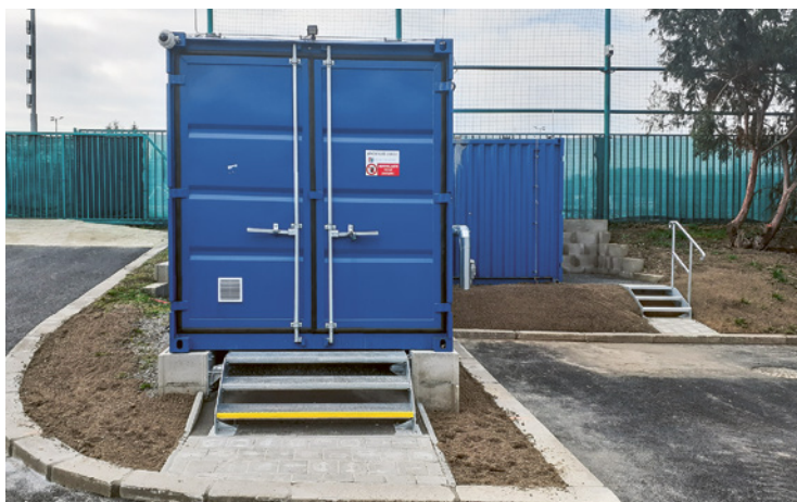
SLAVIA: Odtud se vyhřívají tréninkové plochy stadiónu. Teplo od nás ale Slavia využívá i k temperování budovy a ohřevu teplé užitkové vody.
